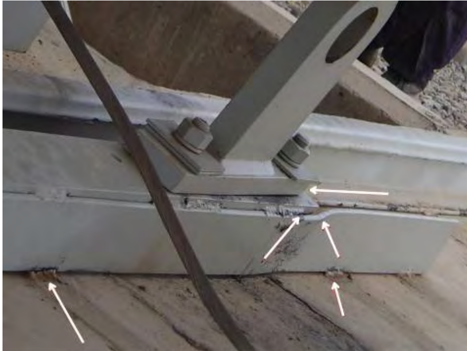
شکل (۶-۲۱): شکست جوشها و تابیدگی نبشی نشیمن ترانسفورماتور
