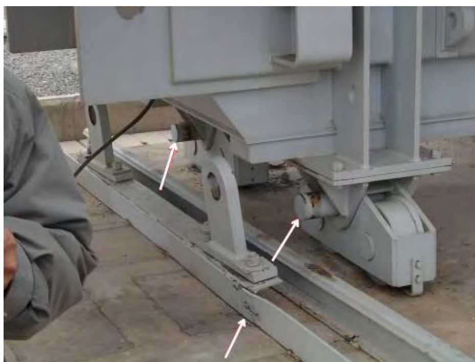
شکل (۶-۲۰): لغزش ترانسفورماتور و خروج پینها از محل خود
