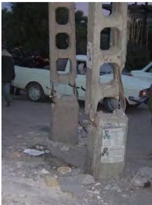
شکل (۳۲-۶): شکست پوشش بتنی و کمانش آرماتورهای طولی
