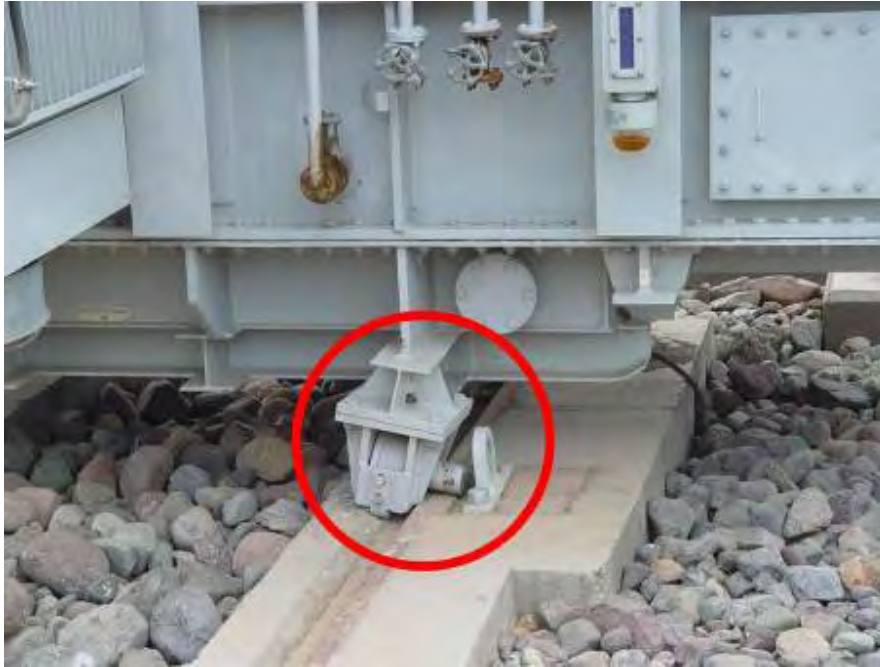
شکل (۶-۱۷): افتادن ترانسفورماتور 132 kv از روی ریل
