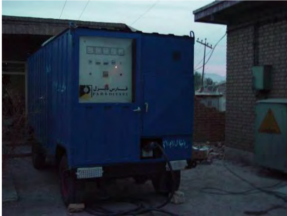
شکل (۶-۴۱): دیزل سیار تولید برق در یکی از مراکز مخابرات شهر بم
