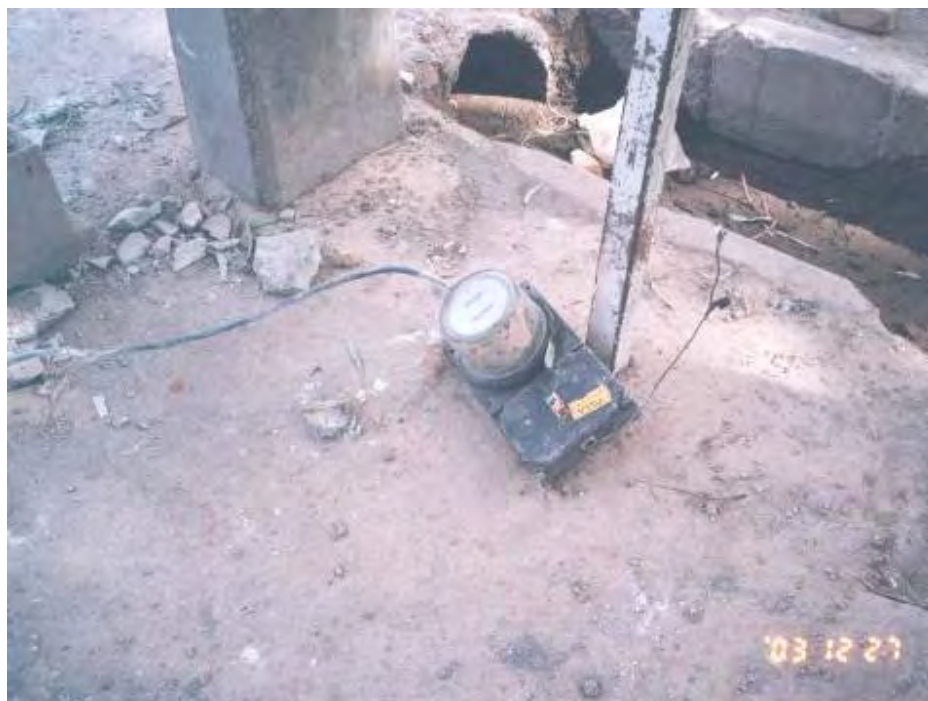
شکل (۶-۳۵): صدمه دیدن انشعاب برق در اثر تخریب ساختمان
