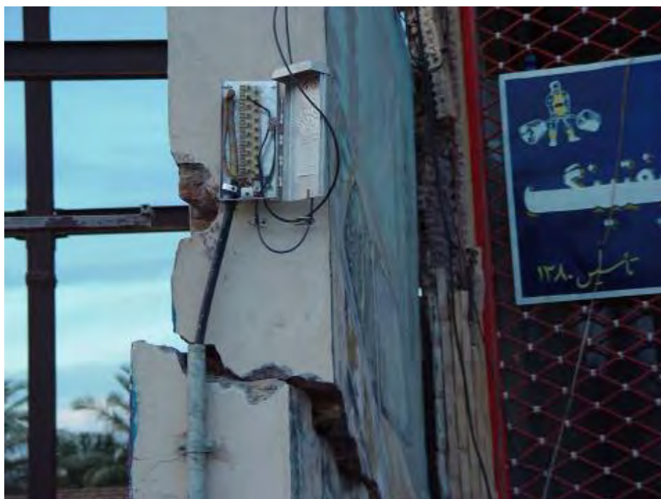
شکل (۶-۴۰): صدمه دیدن انشعابات تلفن در اثر صدمات وارد به ساختمان
