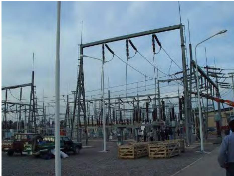
شکل (۶-۱۱): نمایی از قسمت 132 kv پست برق شهر بم
