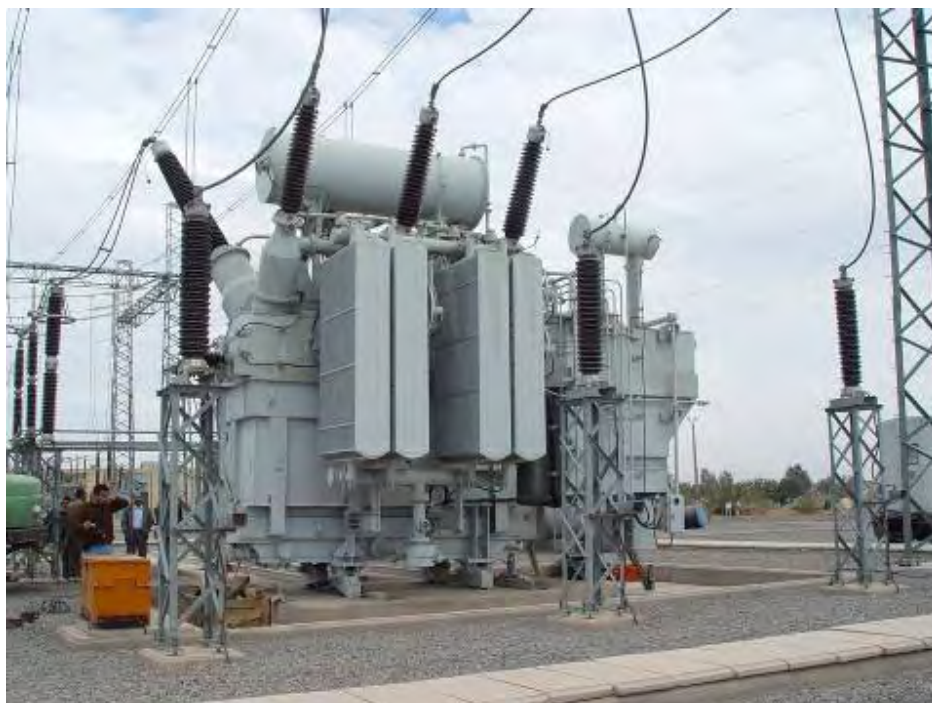
شکل (۶-۱۹): نمای ترانسفورماتور 230 kv
