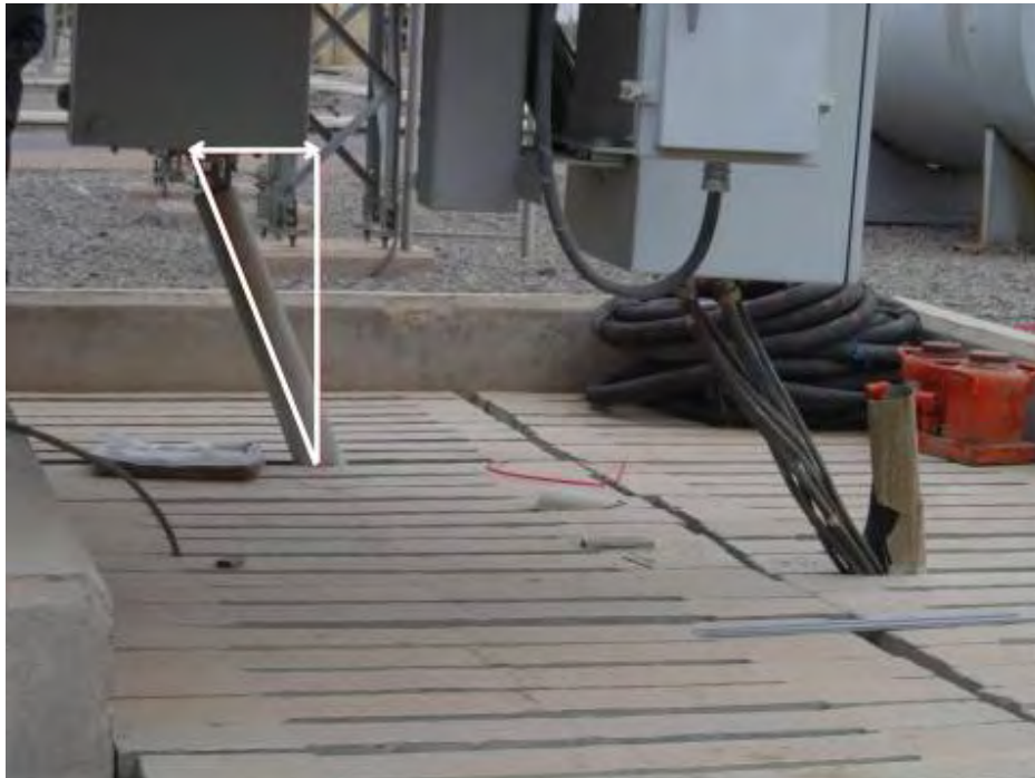
شکل (۶-۲۳): کشیدگی کابلها در اثر لغزش ترانسفورماتور
