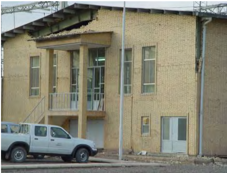
شکل (۶-۳۰): فرروپختن دیوار ساختمان اداری پست برق
