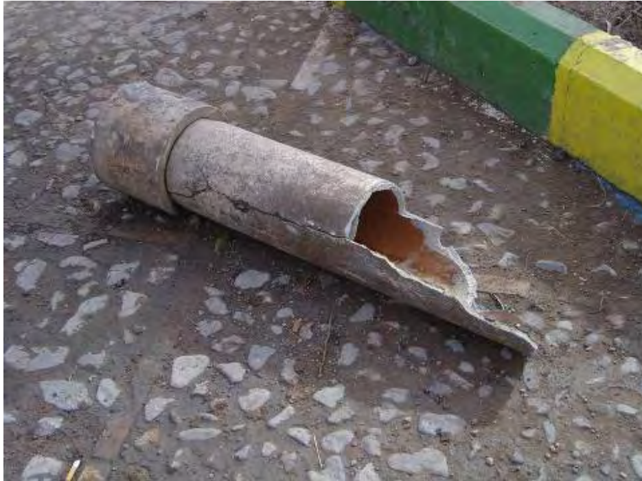
شکل (۶-۷): قسمت صدمه دیده لوله آبستی
