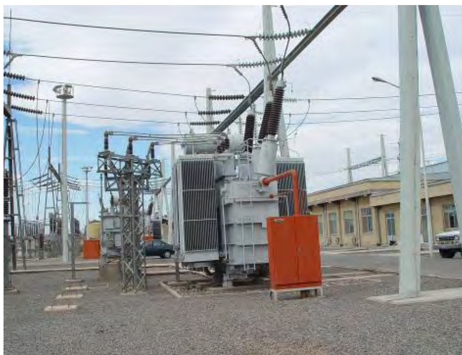
شکل (۶-۱۶): نمای ترانسفورماتور 132 kv
