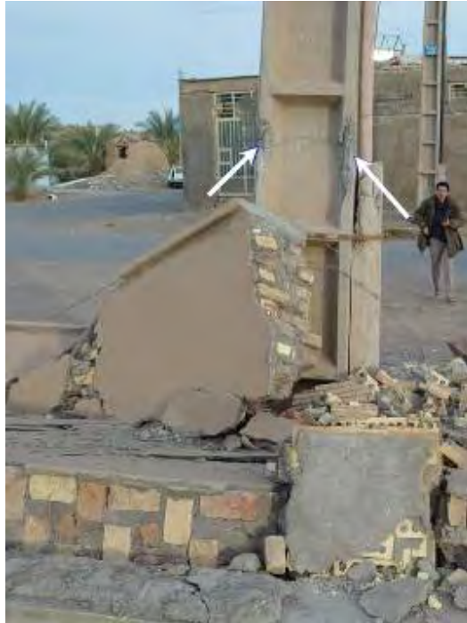
شکل (۶-۱۳): صدمه ایجاد شده در تیر برق در اثر تخریب دیوار
